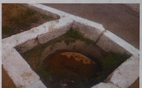
Колодцы, заполненные дождевой водой
