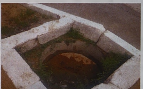
Колодцы, заполненные дождевой водой
